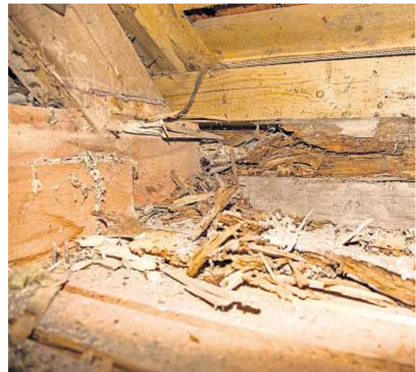
Von einigen Balken sind stellenweise nur noch Späne übrig.
